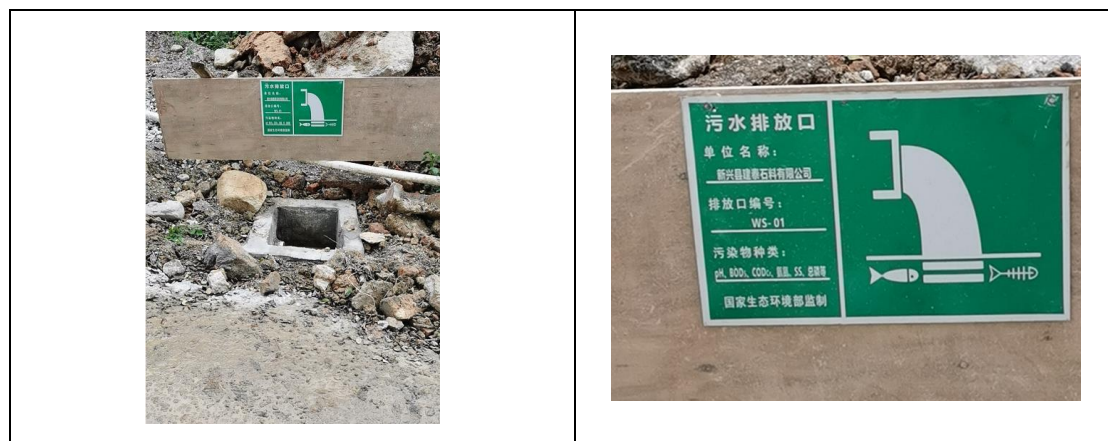
图 4.1-1 废水治理设施照片及废水排放口规范化设置照片
