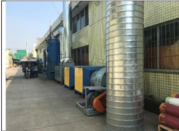
喷淋塔及活性炭吸附装置
