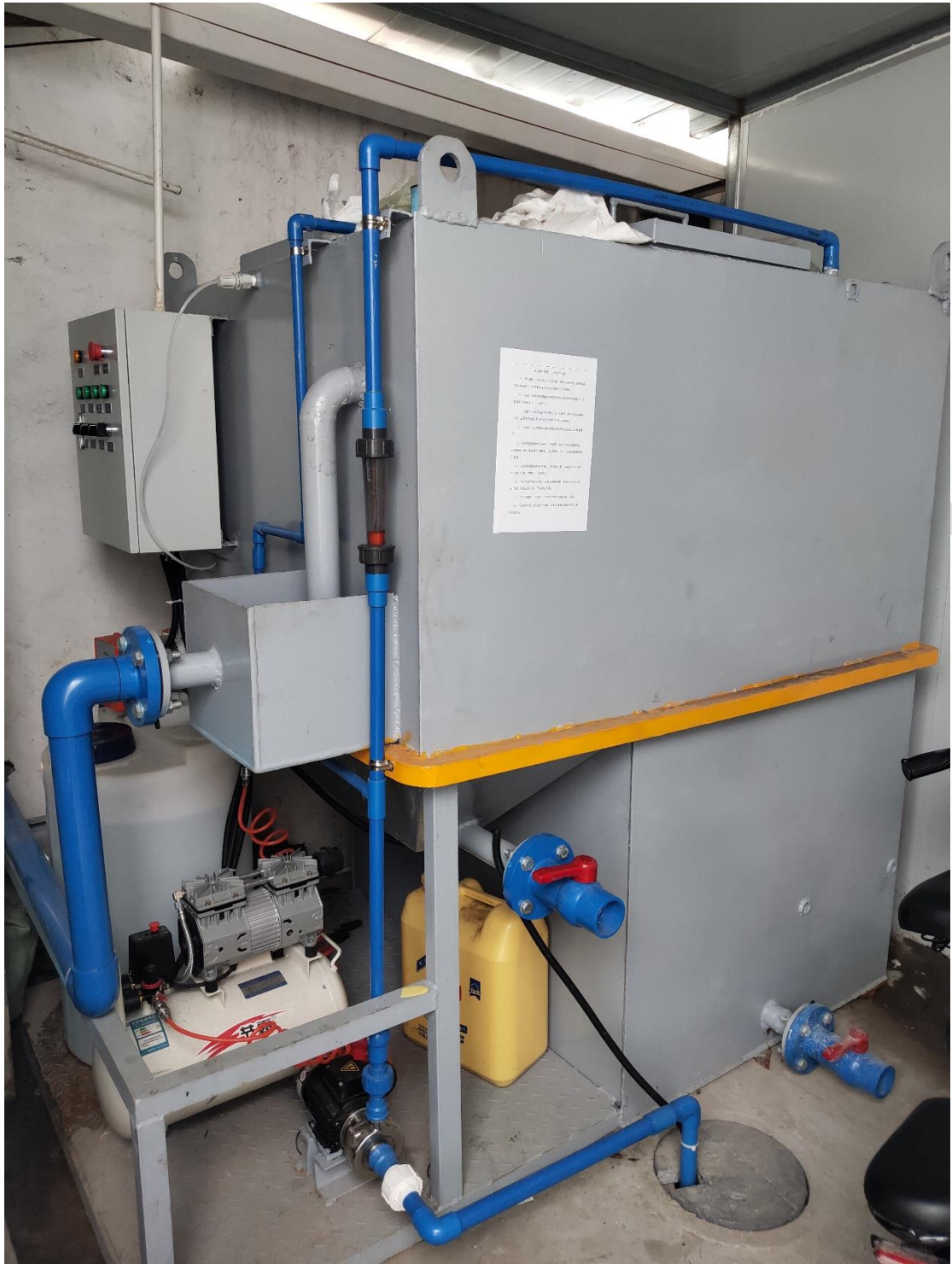
图 4.1-2 废水治理设施照片
